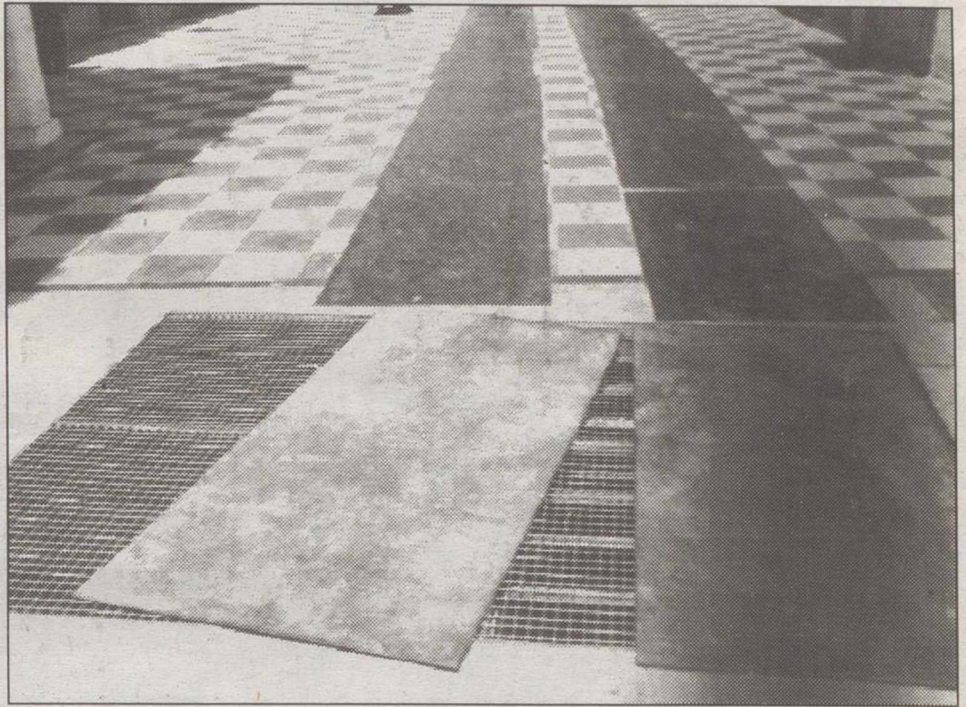
PAUL WHITE Los problemas de resistencia afectan a las rejillas de ventilación.
