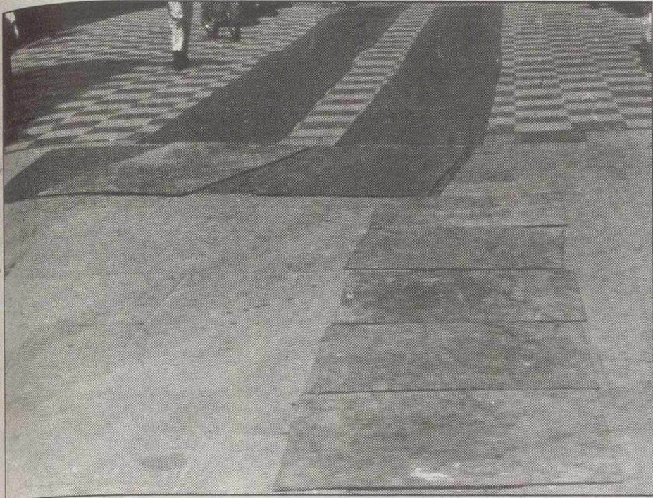
Gruesas chapas protegen una solería imperfecta.
