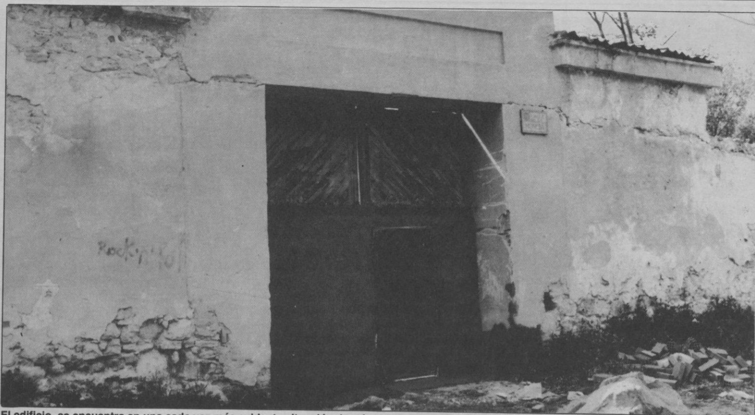
El edificio se encuentra en una cada vez más evidente situación de ruina.
