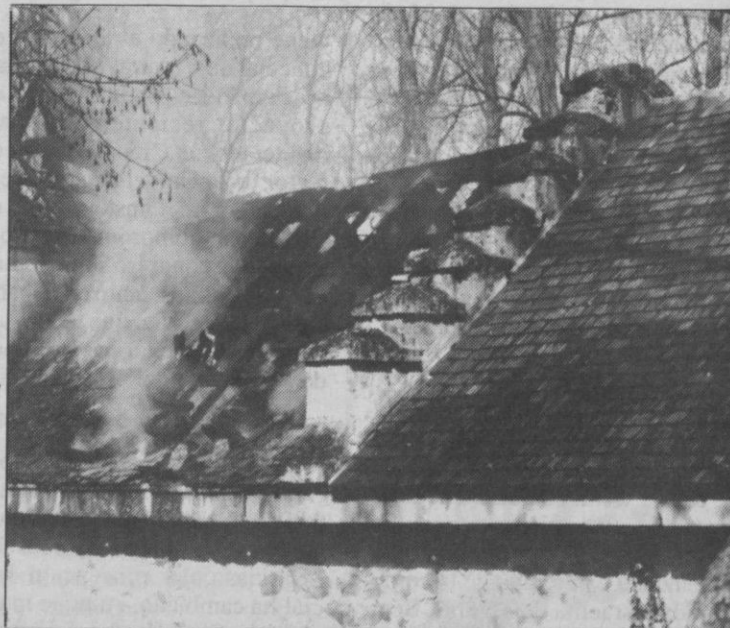
El incendio de abril de 1992 provocó gravísimos daños
