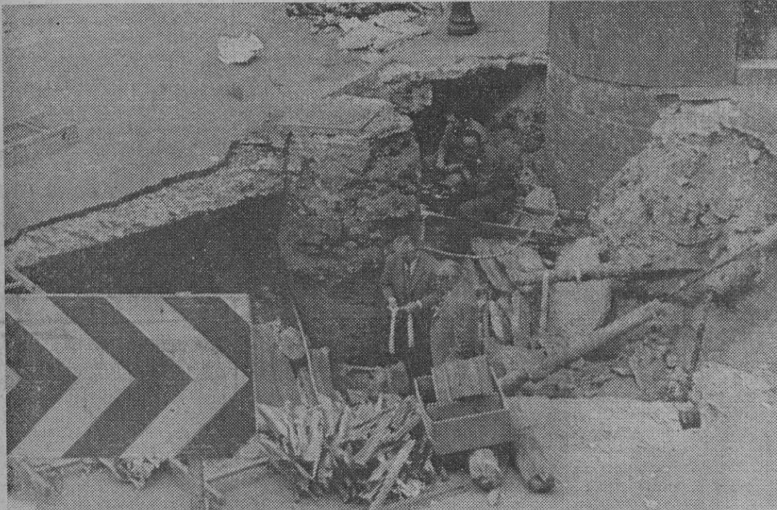
Madrid.—Este es el socavón producido entre las calles de Víctor Pradera y Ventura Rodríguez, que ha producido la rotura de una cámara de registro, por la que mil quinientos abonados quedaron sin servicio telefónico momentáneamente.—(Foto Europa Press)
