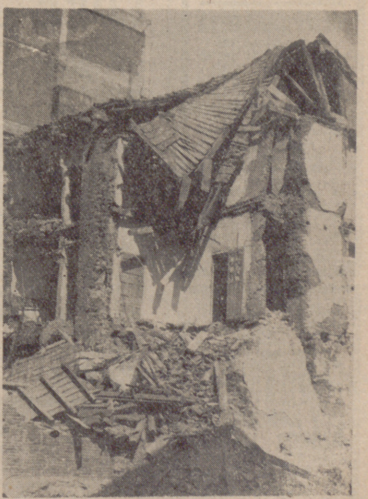
La casa número 7 de la calle de la Democracia se derrumbó ayer en parte. Aunque el inmueble hace tiempo que está deshabitado y por ello no hubo que lamentar desgracias de ninguna clase, el susto entre los vecinos de la citada calle fue mayúsculo. En la fotografía puede apreciarse el estado de la casa en cuestión, que si no se la derrumbaba ya completamente a estas horas, merecería la pena que se proceda a su demolición, para así evitar males mayores.
