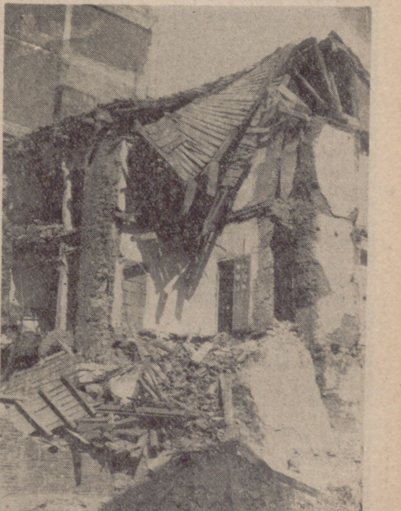
La casa número 7 de la calle de la Democracia se derrumbó ayer en parte. Aunque el inmueble hace tiempo que está deshabitado y por ello no hubo que lamentar desgracias de ninguna clase, el susto entre los vecinos de la citada calle fue mayúsculo. En la fotografía puede apreciarse el estado de la casa en cuestión, que si no se derrumbaba ya completamente a estas horas, merecía la pena que se proceda a su demolición, para así evitar males mayores.
