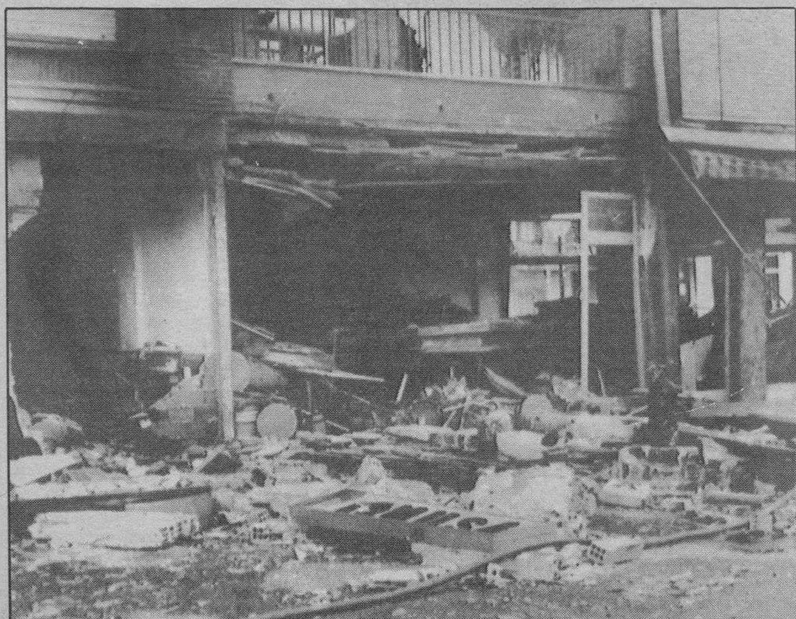
La explosión causó importantes daños en los comercios y viviendas cercanas. Efe
