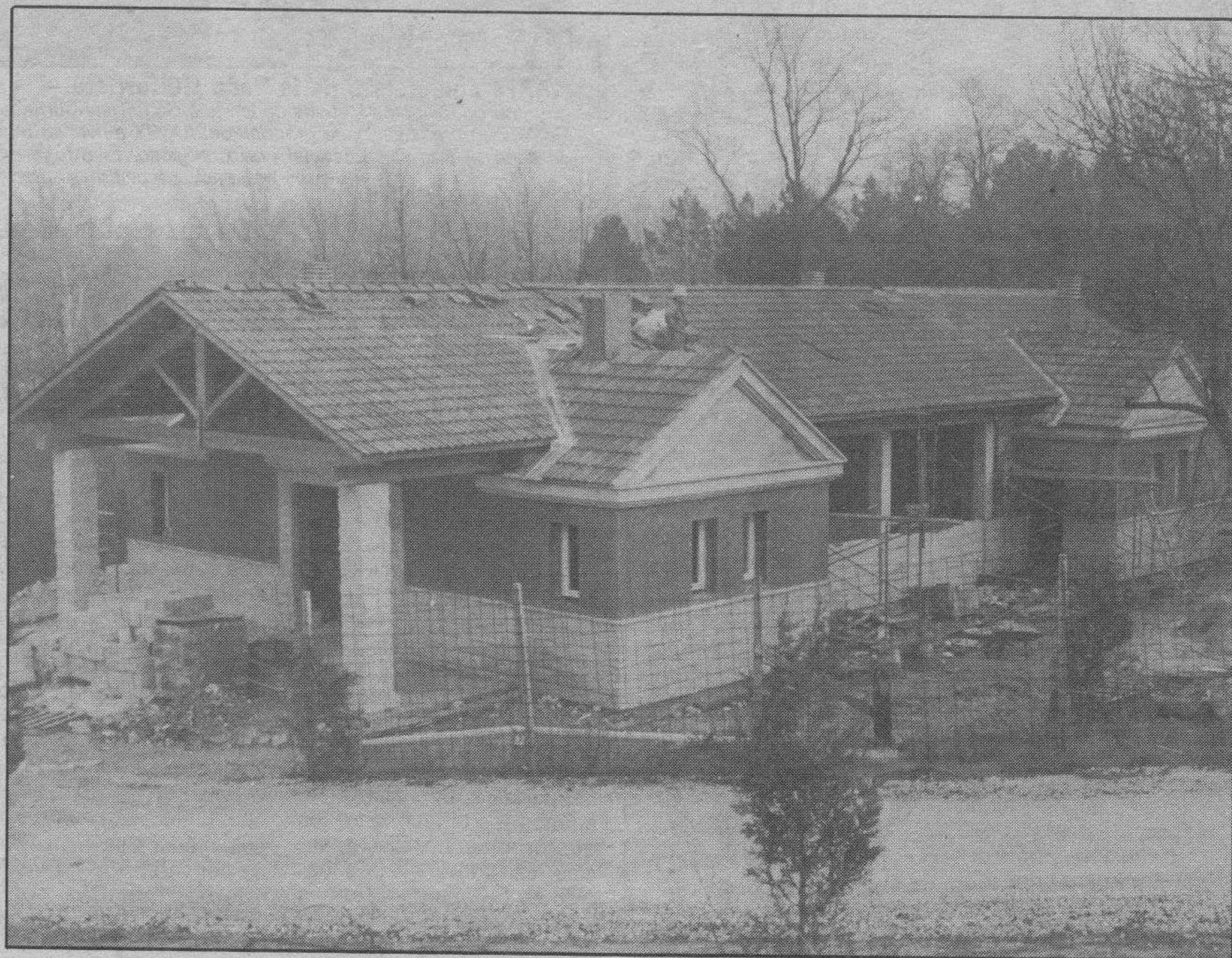
Así será el merendero. — Aunque éste no sea tiempo de hablar de meriendas al aire libre, sí lo es para pasear por nuestros parques burgaleses. Las obras del Merendero Municipal de la Fuente del Prior van avanzando y el edificio está de esta forma que nos permite saber cómo será cuando sea inaugurado el verano próximo.
