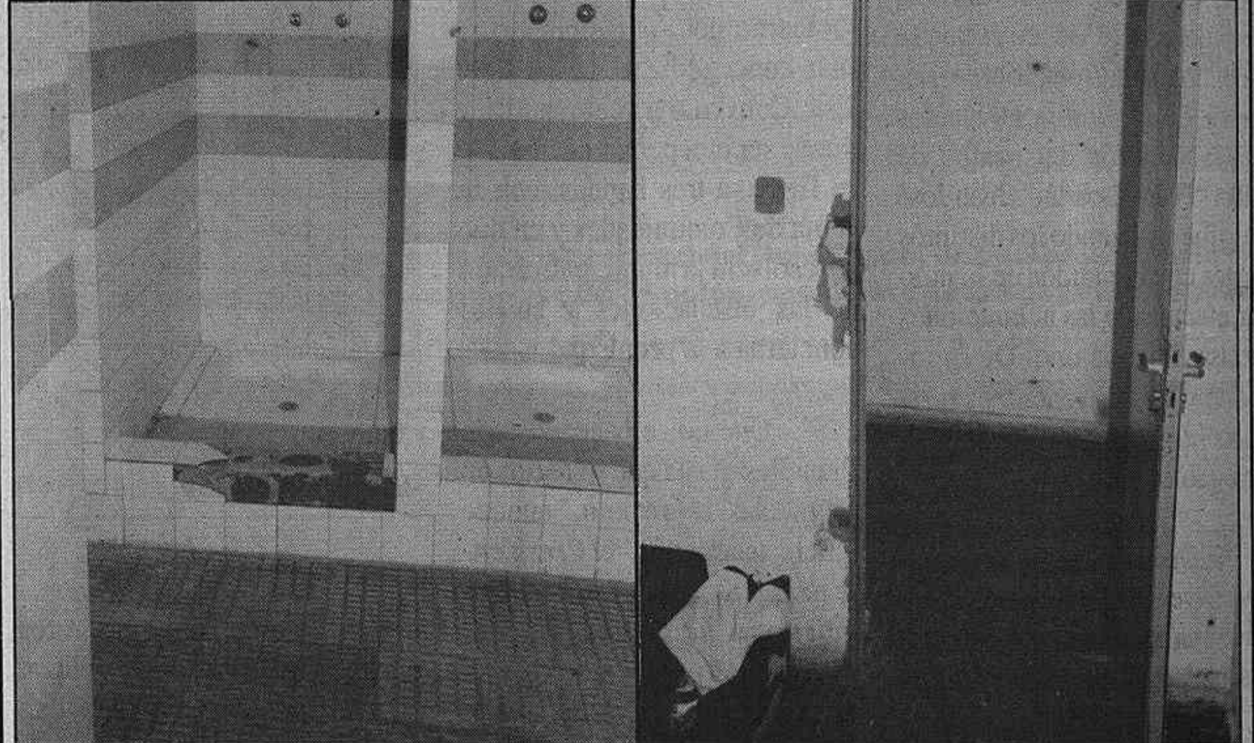
La Junta Directiva del Deportivo Guadalajara ha denunciado repetidamente los desperfectos de los vestuarios del "Pedro Escartín", aunque en teoría en ellos se realizó una obra de mejora que resultó una verdadera chapuza a tenor de lo que nos muestran las fotografías.
