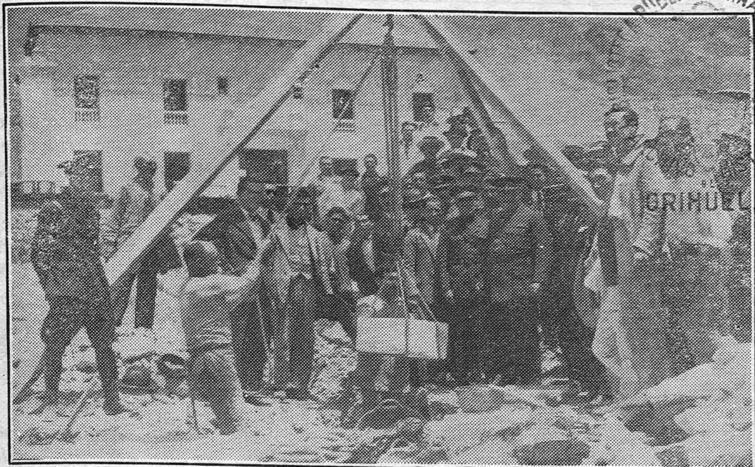
Colocación de la primera piedra del grupo de casas baratas que en la explanada del Cuartel está edificando la Caja de Ahorros de Ntra. Sra. de Monserrate.
