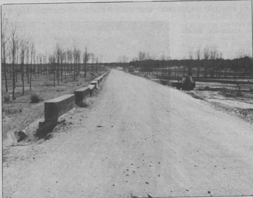
Los paneles solares harán posible la iluminación de este paseo desde esta misma noche.
