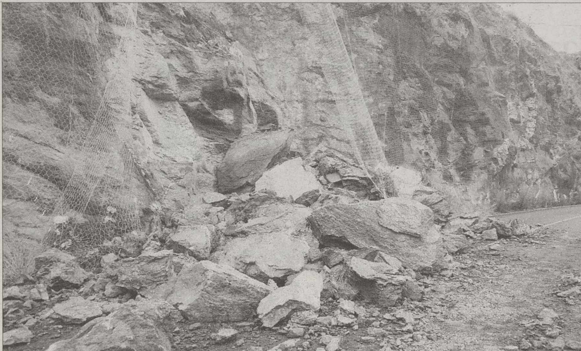
Imagen de uno de los muchos derrumbes causados por el agua en la red viaria de la Sierra. / D.P.
