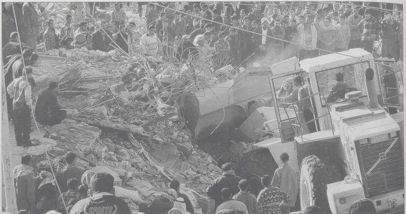
Las excavadoras y los equipos de rescate trabajaron durante todo el día de ayer intentando encontrar supervivientes bajo los cascotes de los edificios derribados. / EPA
