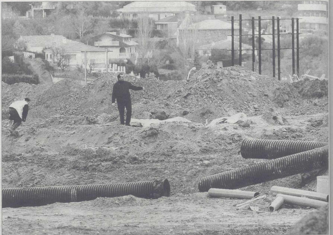
Lugar en el que se produjo el fatal suceso que terminó con la vida de tres operarios marroquíes. /EFE
