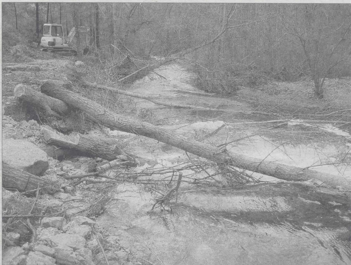
Graves destrozos en el río Mundo para construir una minicentral./LA TRIBUNA
