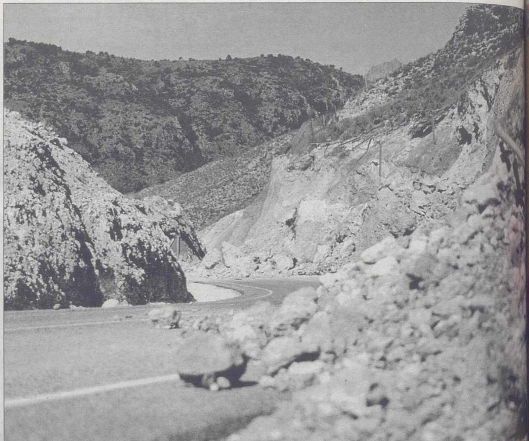
Una imagen de la carretera de acceso a Liétor muestra los derrumbes./LA TRIBUNA
