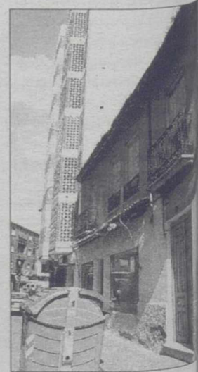
Edificio que podría derribarse.
