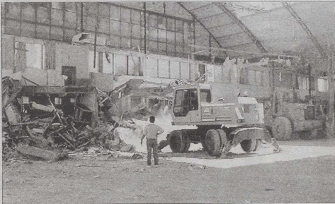
Un momento de la demolición de la nave de Pantalón John. / LA TRIBUNA
