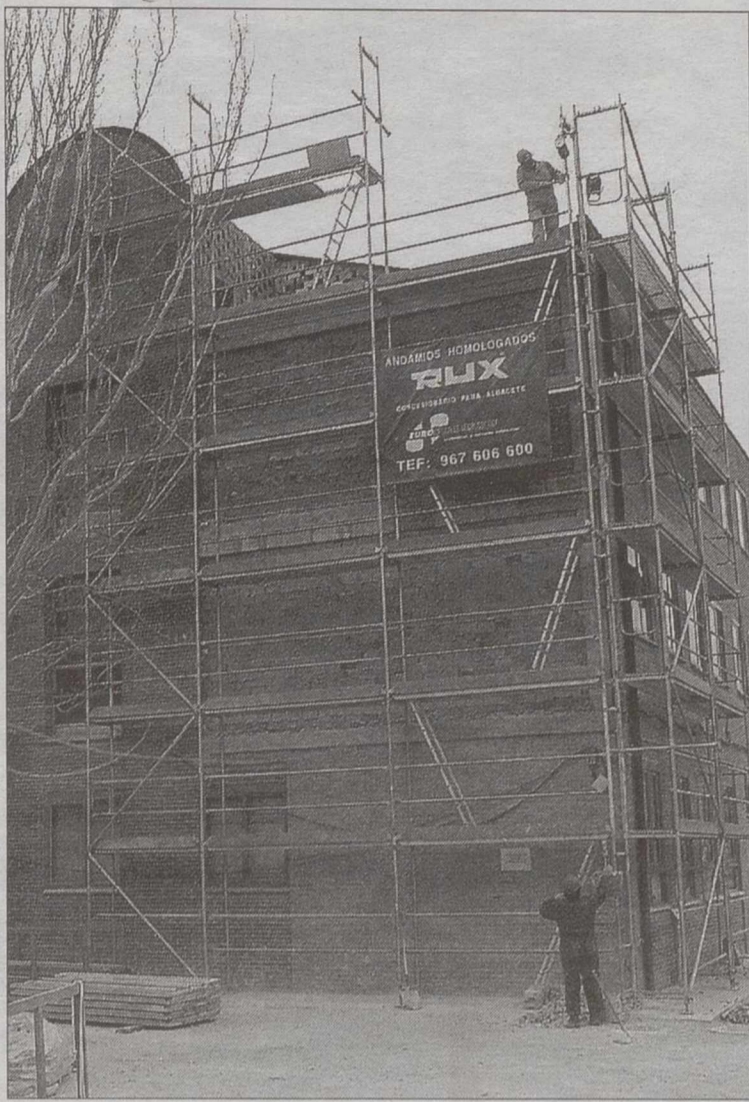
Ya han comenzado las obras de arreglo de la fachada del IES «Don Bosco»/A.P.
