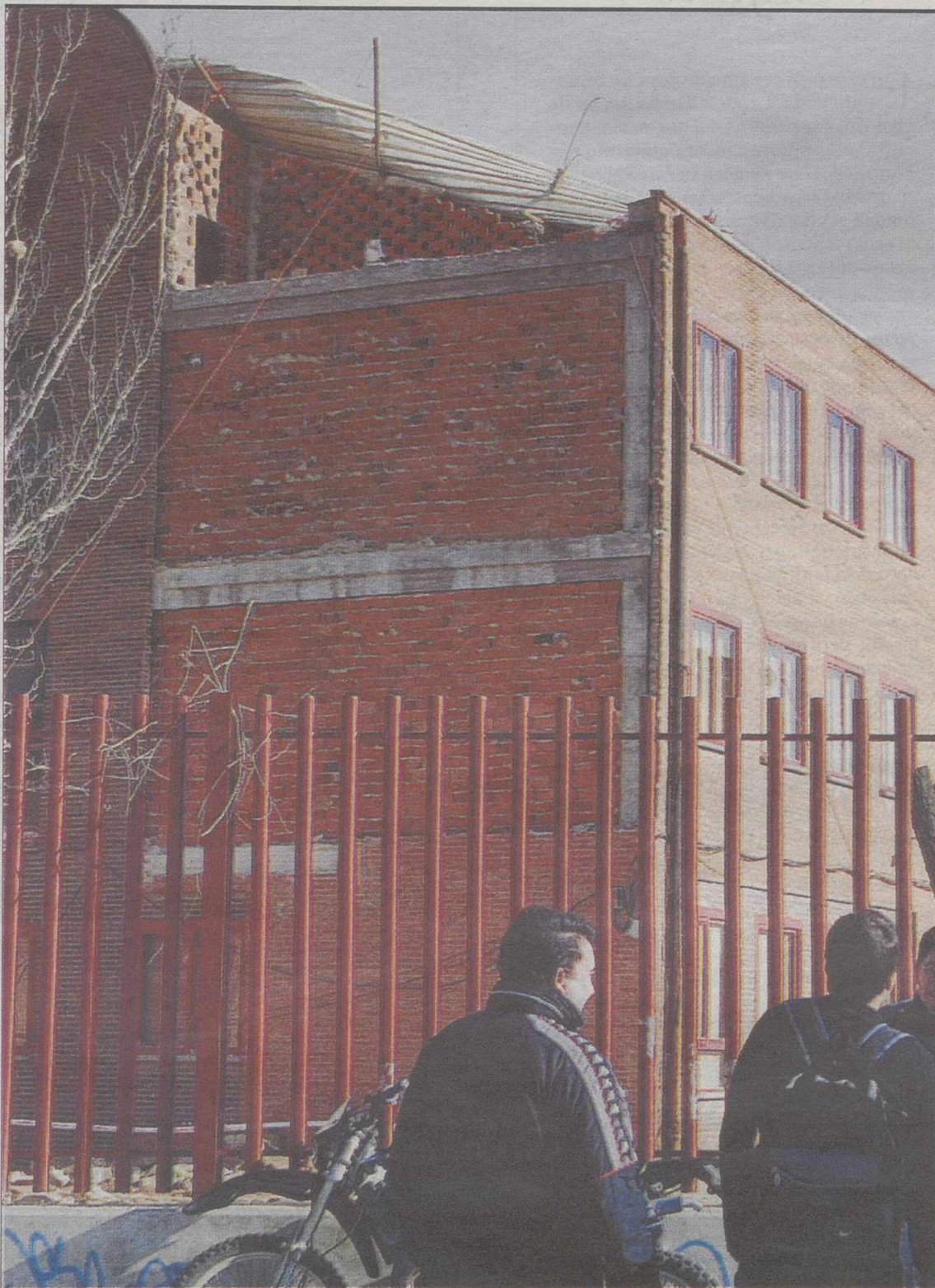
Susto en el Instituto Don Bosco. El revestimiento de un muro del Instituto Don Bosco se desplomó ayer, al parecer a causa del viento y del mal estado de la cubierta. Afortunadamente no se produjeron desgracias personales, aunque el suceso ocurrió poco antes de las dos del mediodía, con centenares de chavales en el centro. / ARTURO PÉREZ
