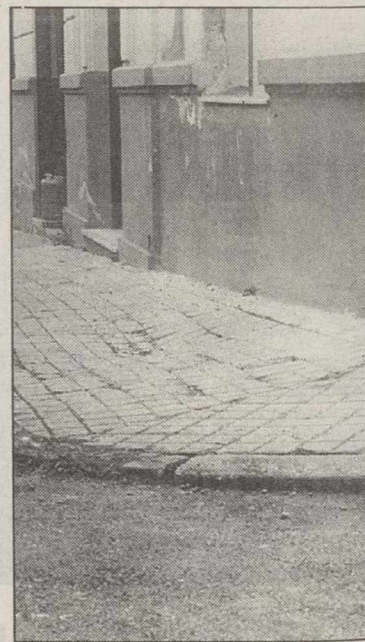
Aceras en mal estado.
