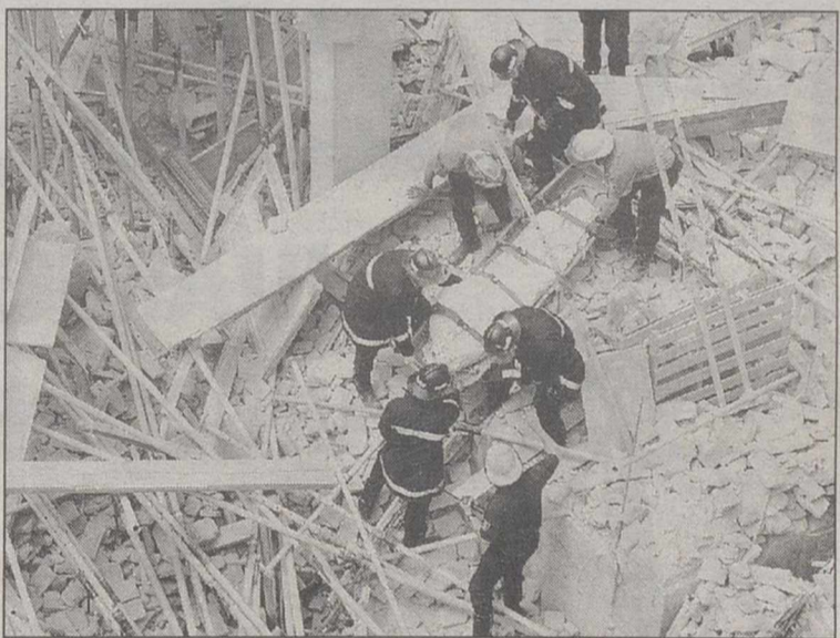
Los bomberos rescatan al fallecido de entre los escombros.
