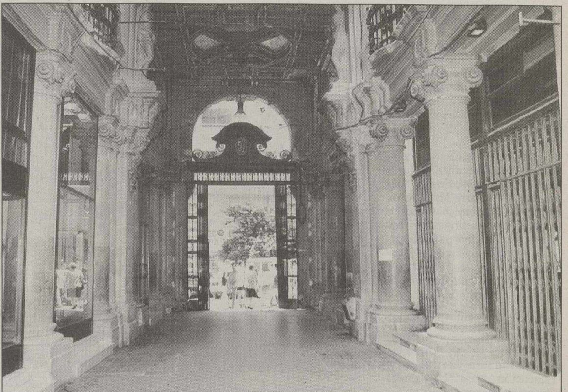
El arquitecto municipal confirma las deficiencias de la estructura del Pasaje de Lodares.
