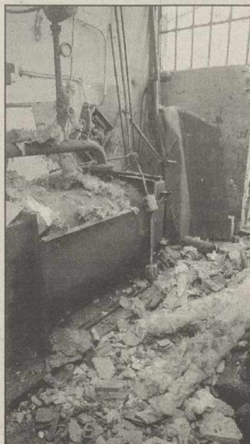
La explosión causó cuantiosos daños.
