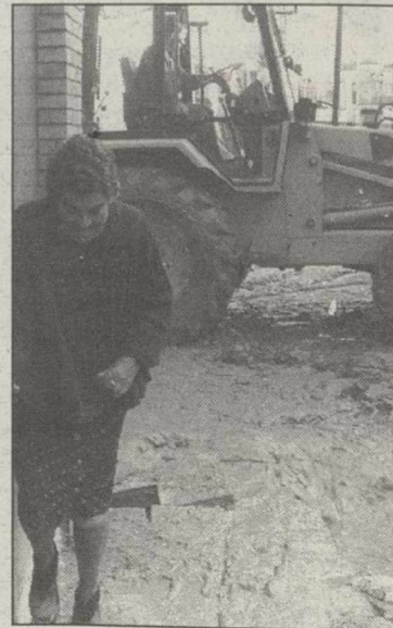
Imagen de los destrozos.
