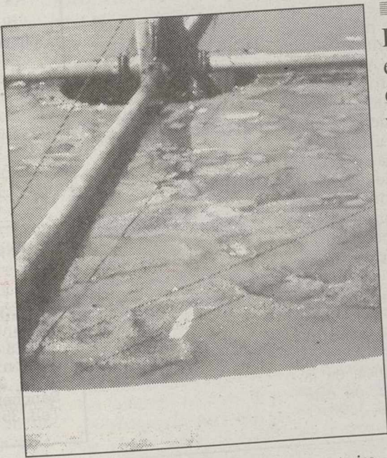
Estado de la depuradora de Issa. Sobran comentarios.
