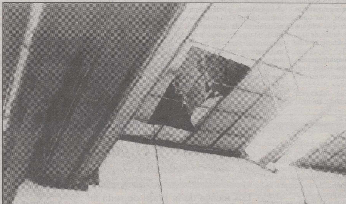
En la foto puede apreciarse uno de tantos recipientes colocados para recoger las filtraciones de agua.
