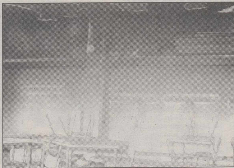
El incendio fue provocado y muy destructivo.
