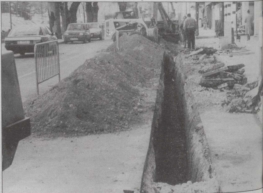
Los tubos se están colocando a una profundidad de dos metros. JESUS MOKENO
