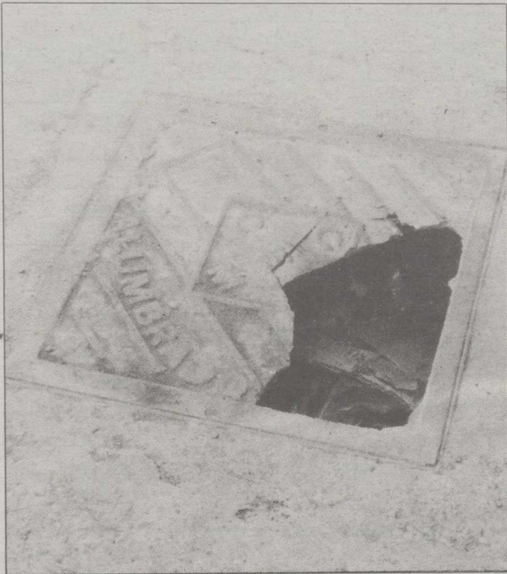
El cajetín de la farola estaba roto.
