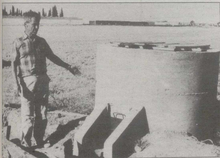
Las obras de infraestructura no se acometen con la presteza deseable.
