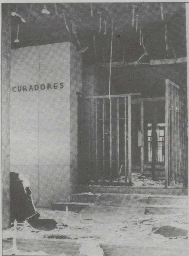
La techumbre se desprendió cayendo sobre las puertas metálicas.
