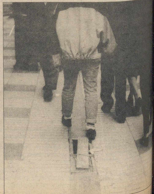
La alcantarilla sin rejilla de la calle Mayor.
