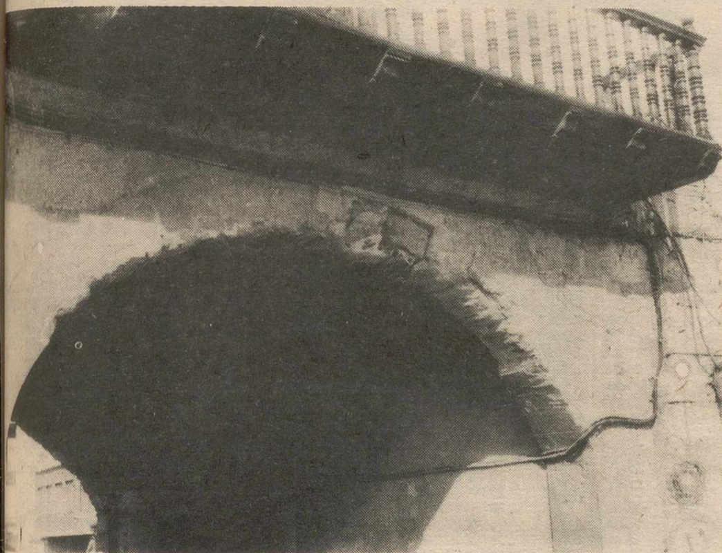
Un primer plano del arco dañado.
