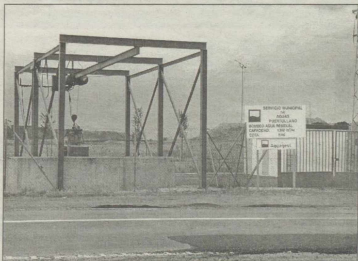
Estación depuradora (EDAR)
