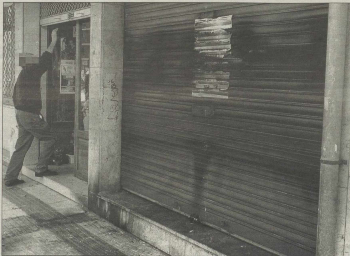
El ataque de los radicales causó daños materiales en la oficina de Correos
