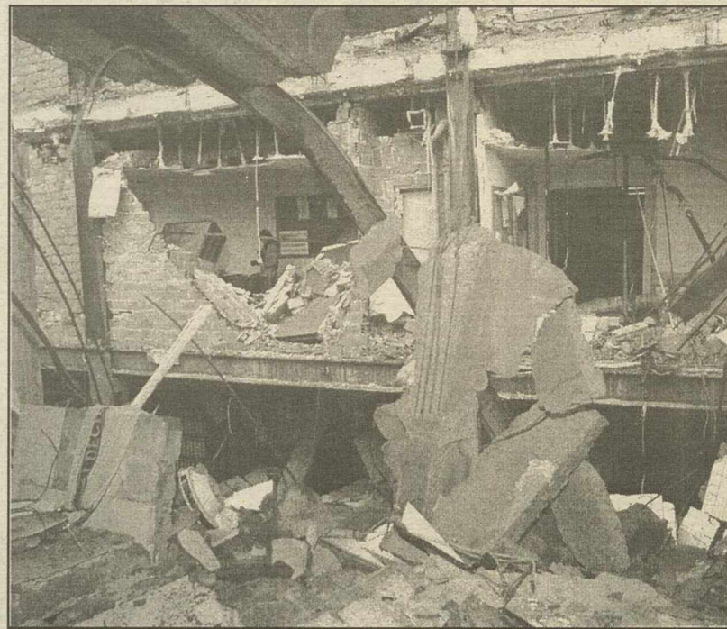
La fachada exterior de Traumatología quedó en este estado. EFE
