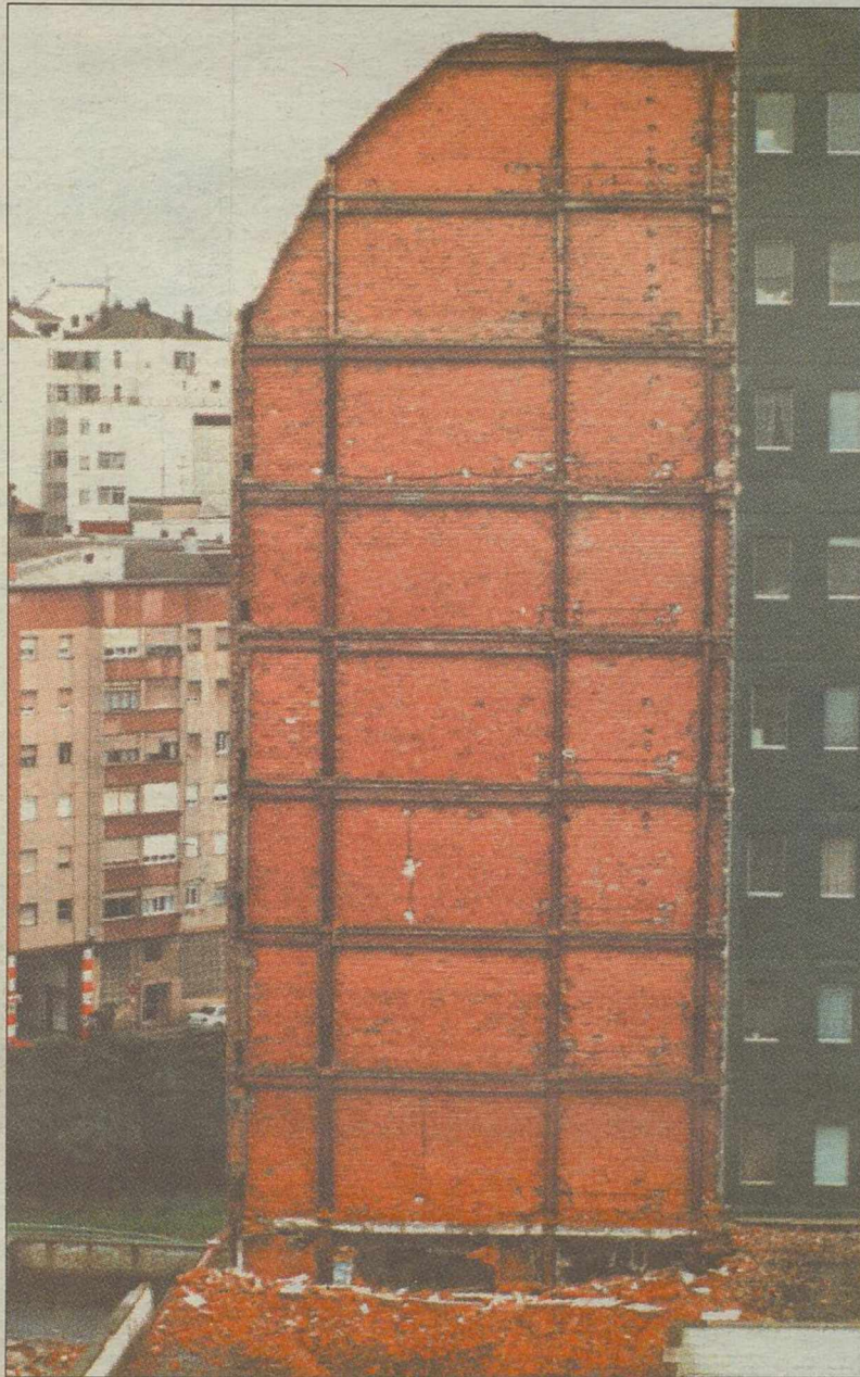
La fachada desprendida y, en su base, el hundimiento.
