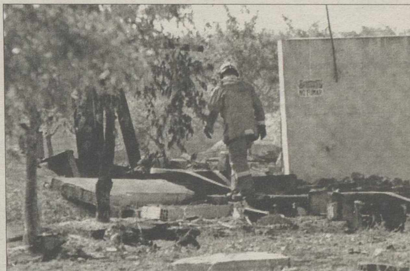
Estado en el que quedó una de las casetas.
