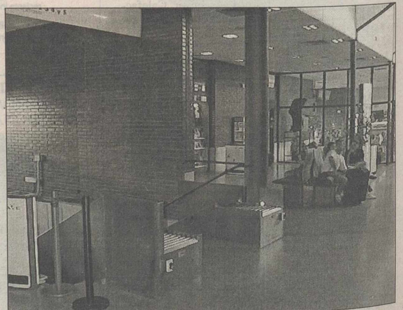
La ejecución prevista de las obras en el interior de la estación es de 3 meses.
