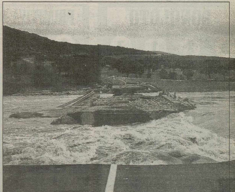
Imagen de lo que quedaba ayer del puente sobre el Guadiana.
