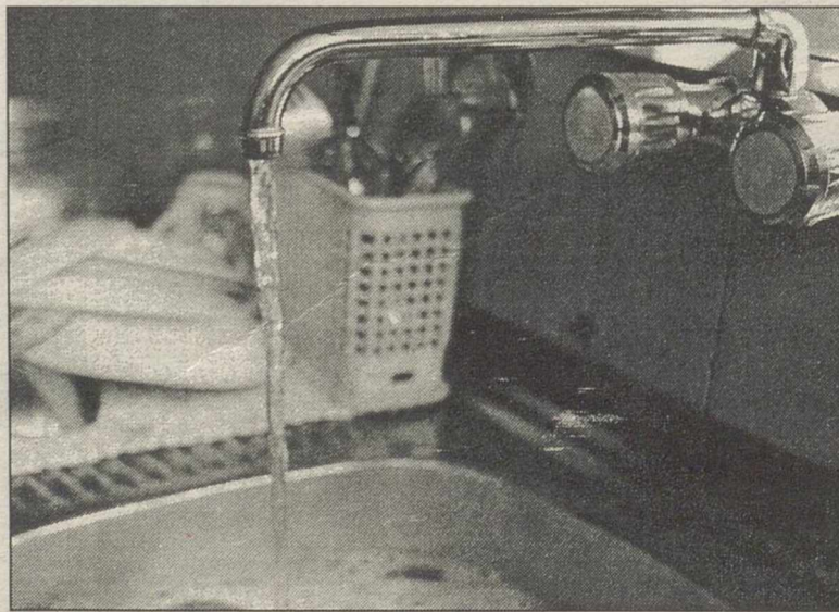
Sería necesario remodelar las conducciones del agua.
