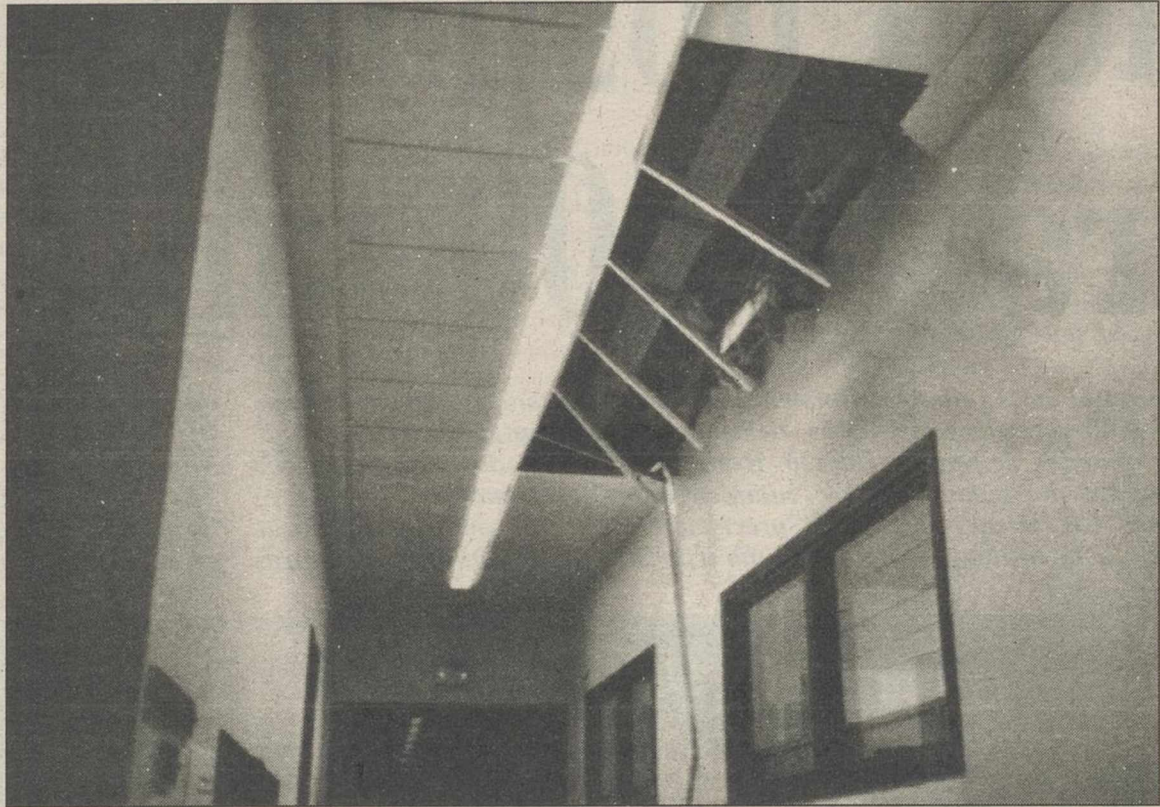
Aspecto del pasillo de Informática tras el desprendimiento de parte del techo.
