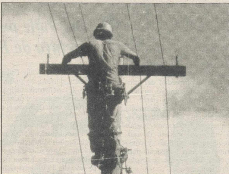
Los vecinos piden que revisen el tendido eléctrico.
