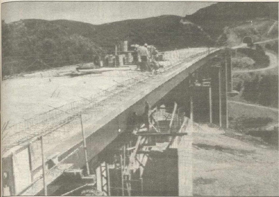
Millones de litros de gasóleo "ilegal" fueron empleados en las obras de AVE
