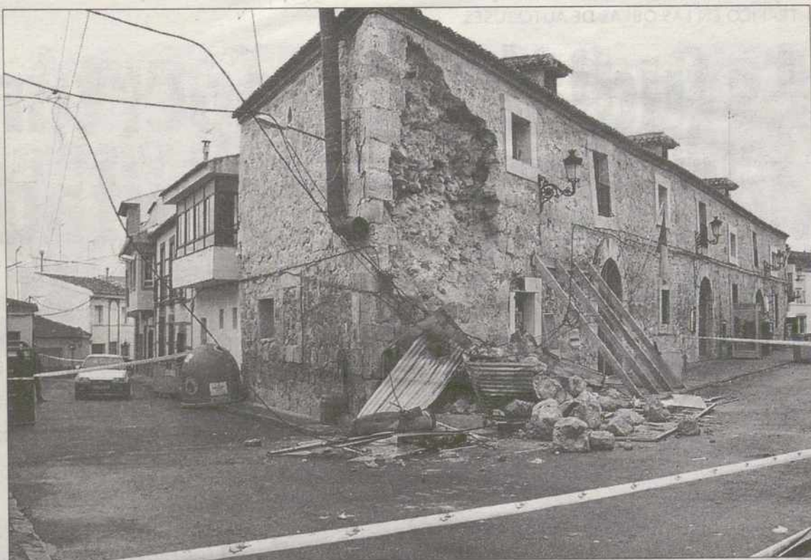
El derrumbe del edificio pudo causar una desgracia mucho mayor. / I. V.
