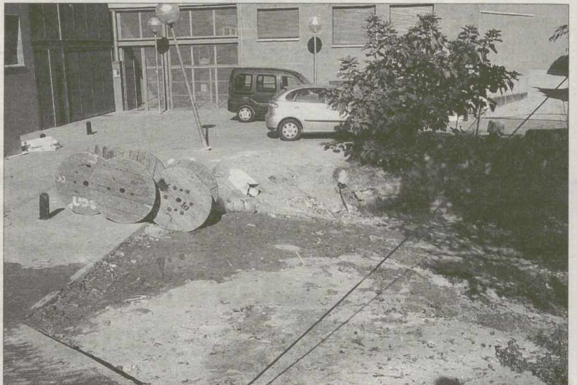
La entrada al portal se encuentra invadida de barro y elementos de construcción. /DAVID PÉREZ
