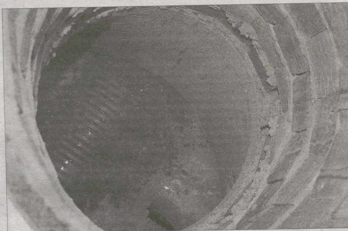
Alcantarilla sin salida, en la que la tubería atraviesa por debajo. /VÍCTOR BALLESTEROS
