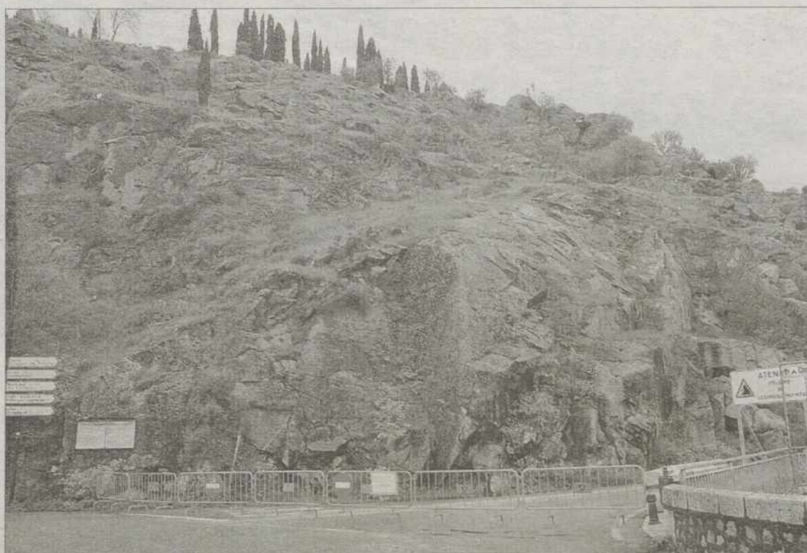
Estado actual de la vía. / DAVID PÉREZ
