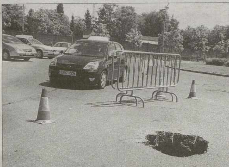
En la imagen, el socavón inicial producido por el hundimiento del pavimento.
