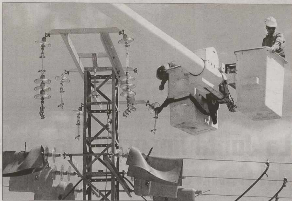
Técnicos de Iberdrola operando en uno de los tendidos antiguos, muy numerosos en la provincia de Toledo. / Y. LANCH
