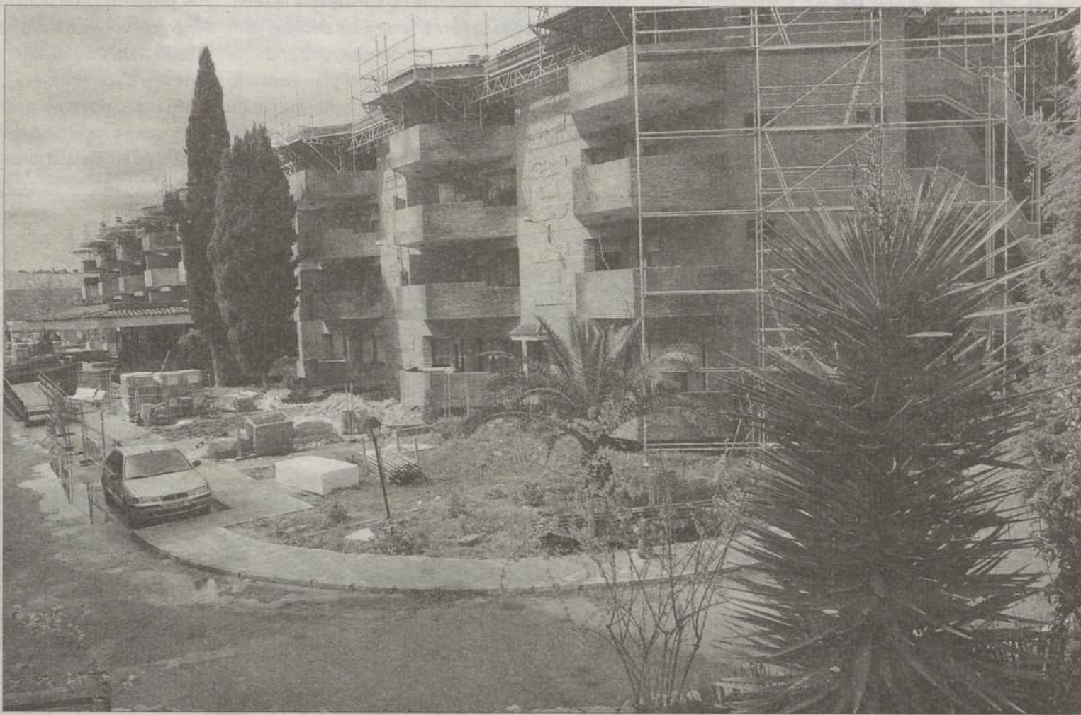
Las obras del centro de mayores de la Avenida de Barber han provocado inundaciones y goteras por la lluvia. / DAVID PÉREZ
