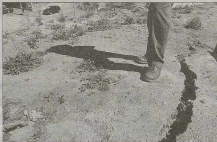
El terreno amenaza con nuevos desprendimientos./DAVID PÉREZ
